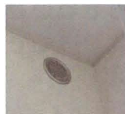
自然排気口(室内)
